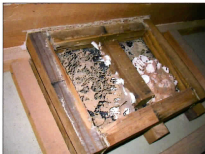
写真 11 天井梁被害部に設置 1階天井2階梁に白蟻被害 梁被害部にボックス設置
