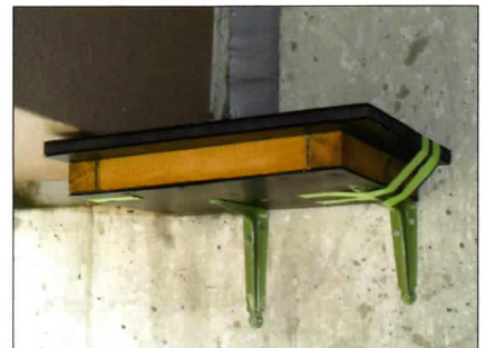
写真 12 コーキング被害部に設置 鉄筋建物のコーキング部に蟻土、白蟻被害 コーキング被害部にブリングボックス設置
