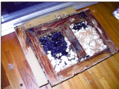
写真 10 フローリング被害部に設置 公民館床フローリングに白蟻被害 床板被害部に、ブリングボックス設置
